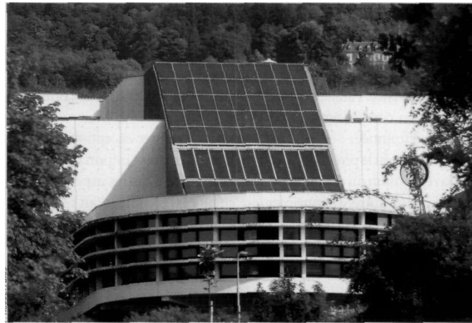
Toutes les collectivités – et non plus les seules communes – pourront vendre à EDF le courant issu de sources renouvelables. La centrale photovoltaïque d'une puissance de 14,4 kWc du lycée du Grésivaudan, à Meylan (Isère).
