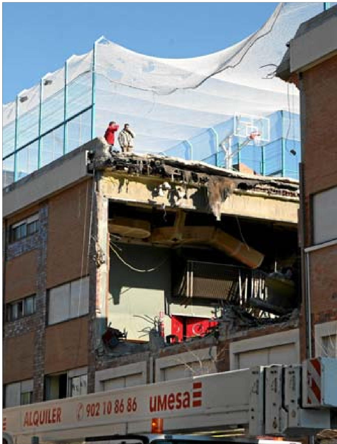
El colapso del edificio del colegio Sagrado Corazón, en la calle Paraguay, destruyó el salón de actos. / SERGIO GONZÁLEZ
