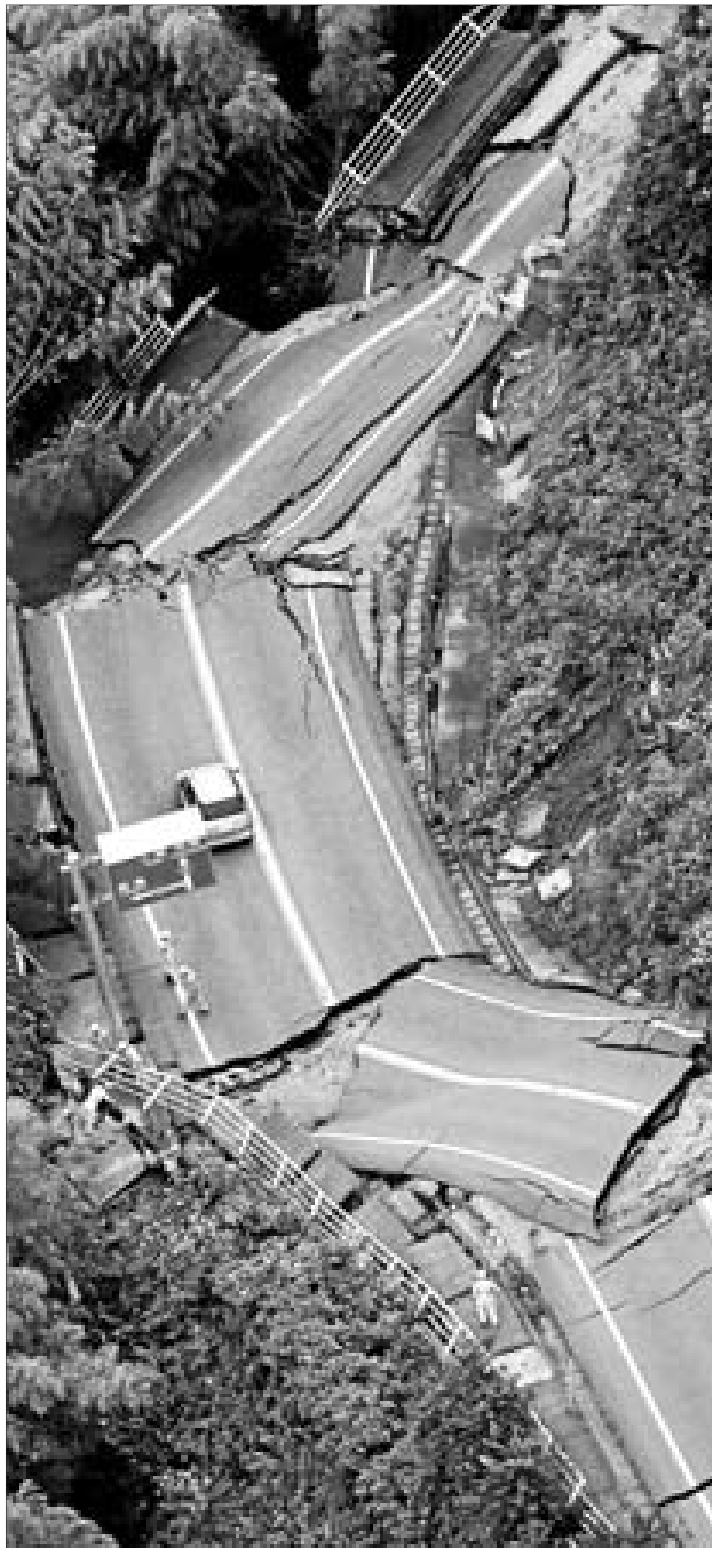
Una carretera nacional destruida por el temblor en Nagaoka (noroeste). / AP
