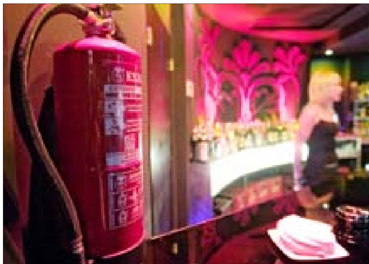
Imagen de uno de los extintores del local, con la camarera Lorena al fondo.
