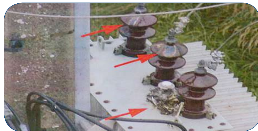
Transformateur avec vis isolant HT et avec déchets de nids d'oiseaux.
