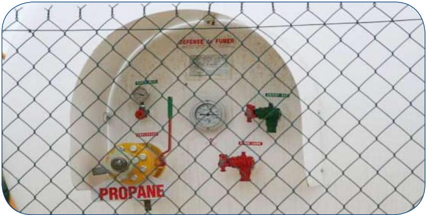
Détail de bouche de charge et d’instruments de mesure (niveau de charge, manomètre de pression, prises de phase liquide et gaseuse)
