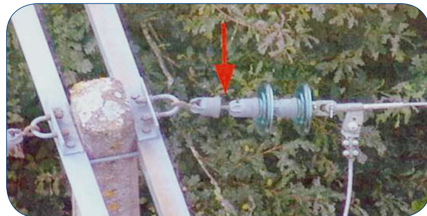
Détection de rupture d'isolateur sur une ligne de 20kV.
