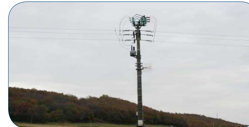
Centre de transformation aérien avec commande manuelle
