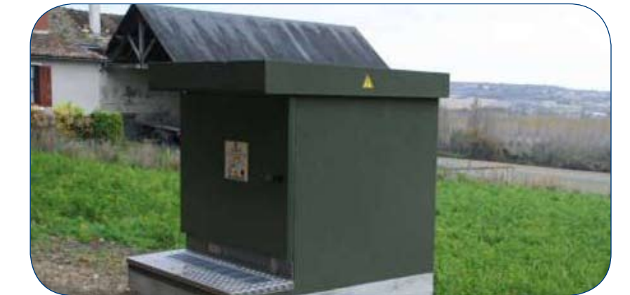
Centre de transformation avec interrupteur SF6 télécommandé
