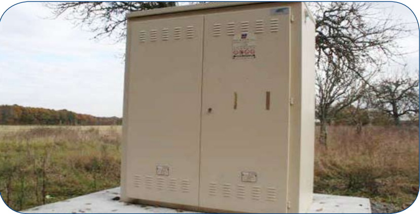
Station de Régulation et de Mesure
