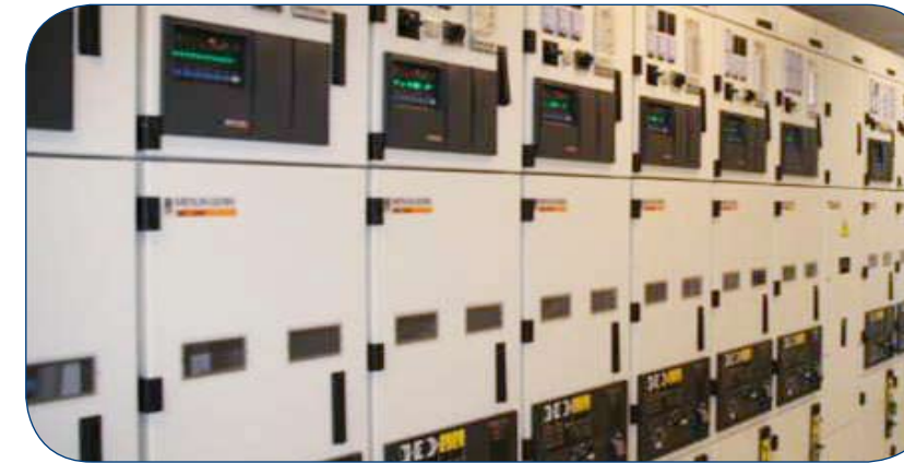
Centre de distribution à 20kV dans la sous-station de St Laurent
