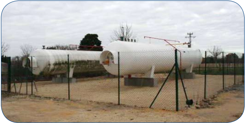
Réservoirs hors-sol de propane
