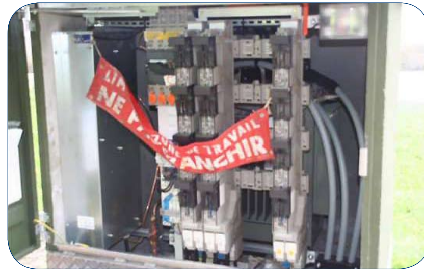
Sortie BT du centre de transformation 20/04kV
