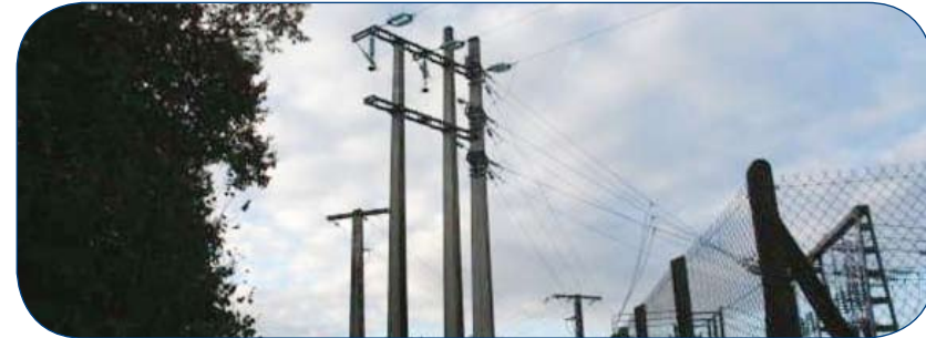
Sortie 90kV de la sous-station de Mignaloux.
