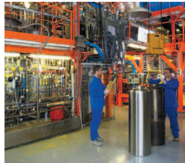
> Prototype de vitrification équipé d'un creuset froid nucléarisé.
